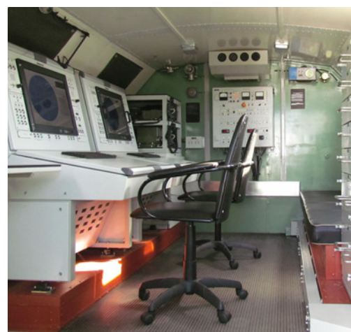
Отсек с автоматизированным рабочим местом (АРМ) аппаратной машины РЛС TRS-2D Automated workstations of the TRS-2D control post
